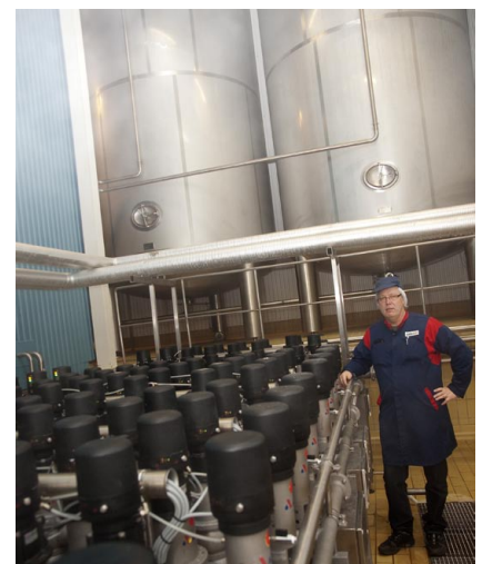
I bakgrunden syns några av de stora kärl där Åbros öl lagras till rätt mognad och smak. Framför Gullmar Johansson är det rörsystem som gör att rätt sort hamnar i rätt flaska och burk.
